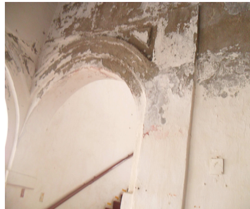
PARED INTERNA CON FILTRACION.
