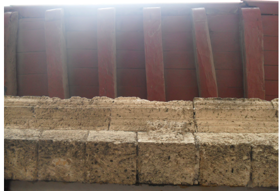
BALCON EXTERNO DETERIORADO
