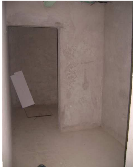
H. Arroz Barato. Obras inconclusas
