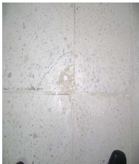
H. Arroz Barato. Pisos deteriorados
