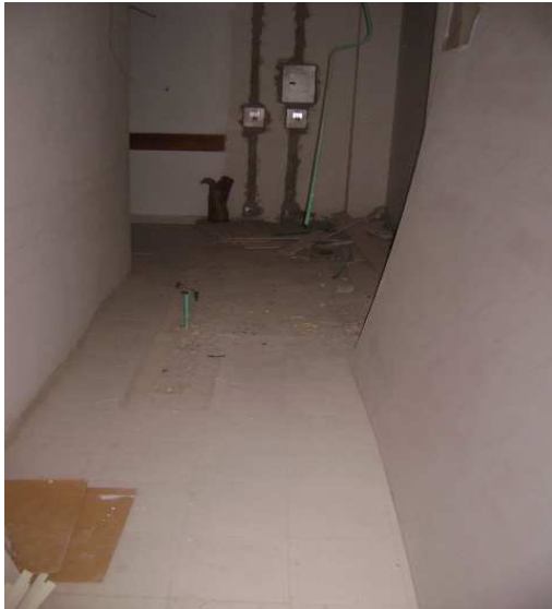
H. Arroz Barato. Obras Inconclusas
