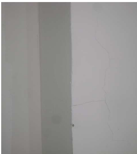
H. Arroz Barato. Fisuras Pañetes
