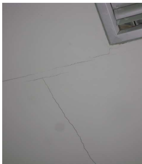
H. Arroz Barato. Fisuras Cielo Raso
