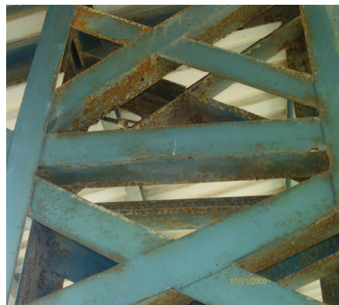
Ilustración 2 Cancha de Softbol Chiquinquirá- Corrosión
