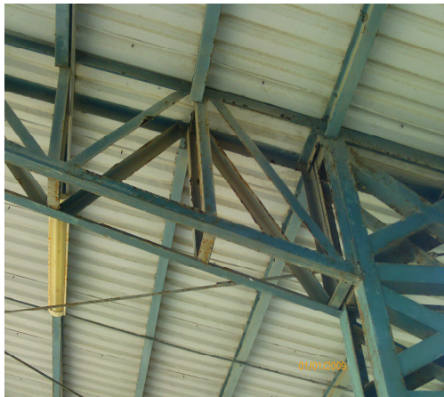
Ilustración 1 Cancha de Softbol Chiquinquirá - Corrosión
