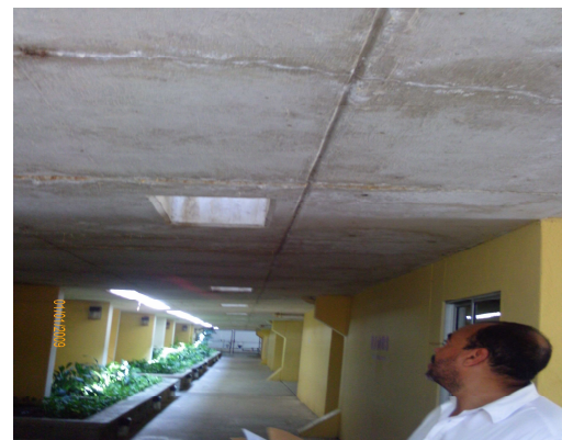
Ilustración 4 Coliseo de Combate- Filtraciones
