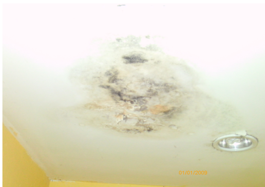
Ilustración 3 coliseo de Combate – Filtraciones
