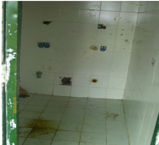
Ilustración 7E. Softbol Pozón – Baños en mal estado
