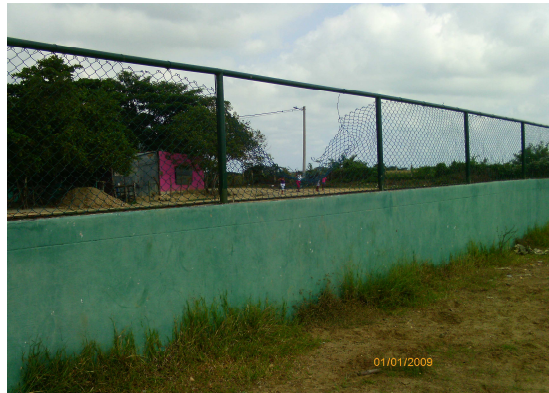
Ilustración 6 Estadio de Softbol del Pozón - Deterioro
