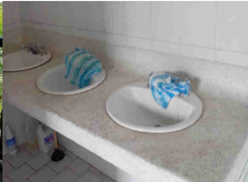
BAÑOS SEGUNDO PISO INSTALACIONES DADIS
