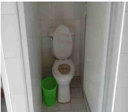
BAÑOS SEGUNDO PISO INSTALACIONES DADIS
