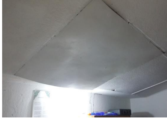
Oficina de almacén-daño estructura
