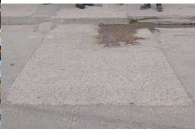
Estado actual de la placa con hundimiento.
