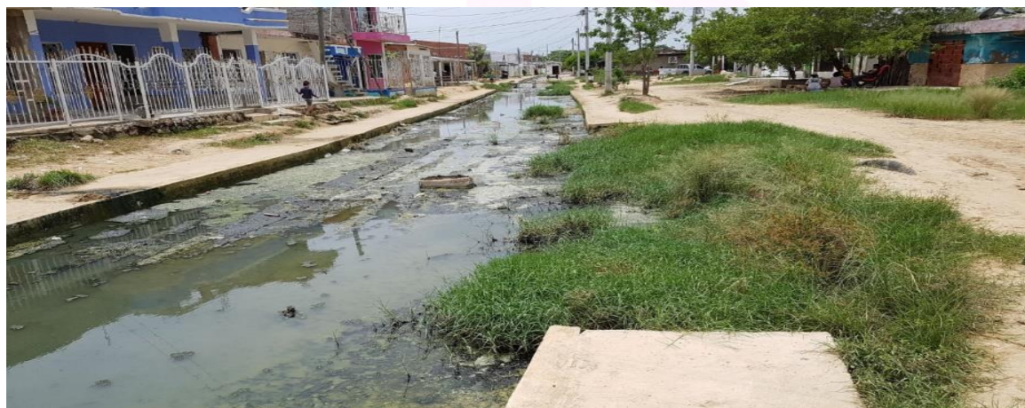
Imagen No 1. Tramo 0+250.00 hasta 0+340.00 donde debió hacerse canal de descarga hacia la ciénaga
